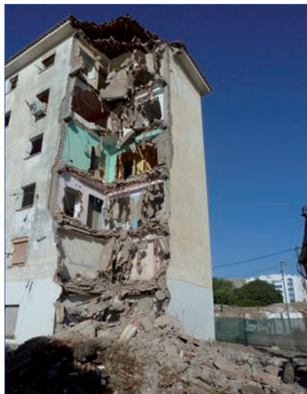
Foto 1. Demolición de un edificio. Generación de los residuos de construcción y demolición, RCD.
