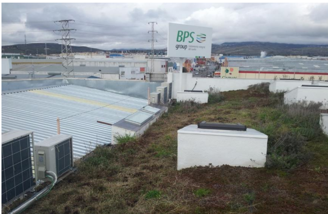
Fig. 2: Techo verde extensivo en polígono de Peligros, Granada.
